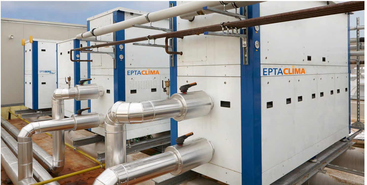
Epta BergMS: Epta konfiguriert und berechnet Kühlanlagen mitsamt Verrohrung
